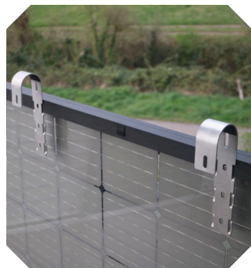
Solarpanels mit „Solar-Hook“ Foto: Sebastian Müller
