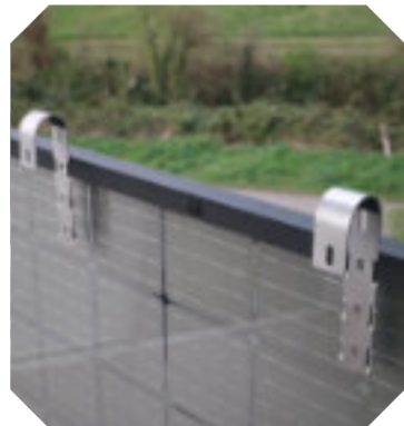
Solarpanels mit „Solar-Hook“ Foto: Sebastian Müller
